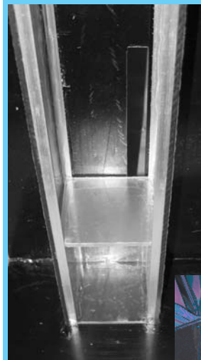
Cabina en el hueco, de frente
